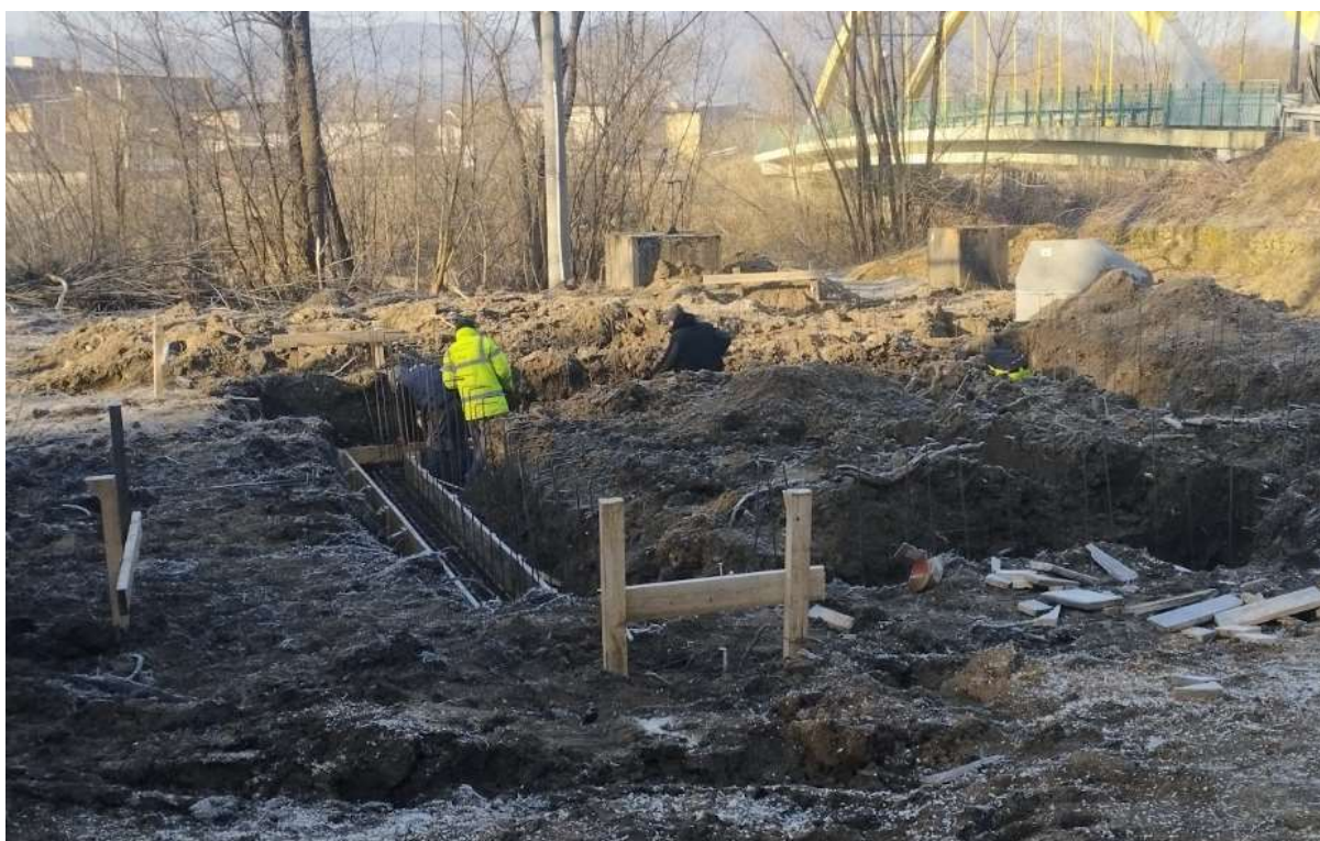
Zdjęcie: Rozpoczęcie prac budowlanych w zakresie rozbudowy stacji uzdatniania wody w Zembrzycach
